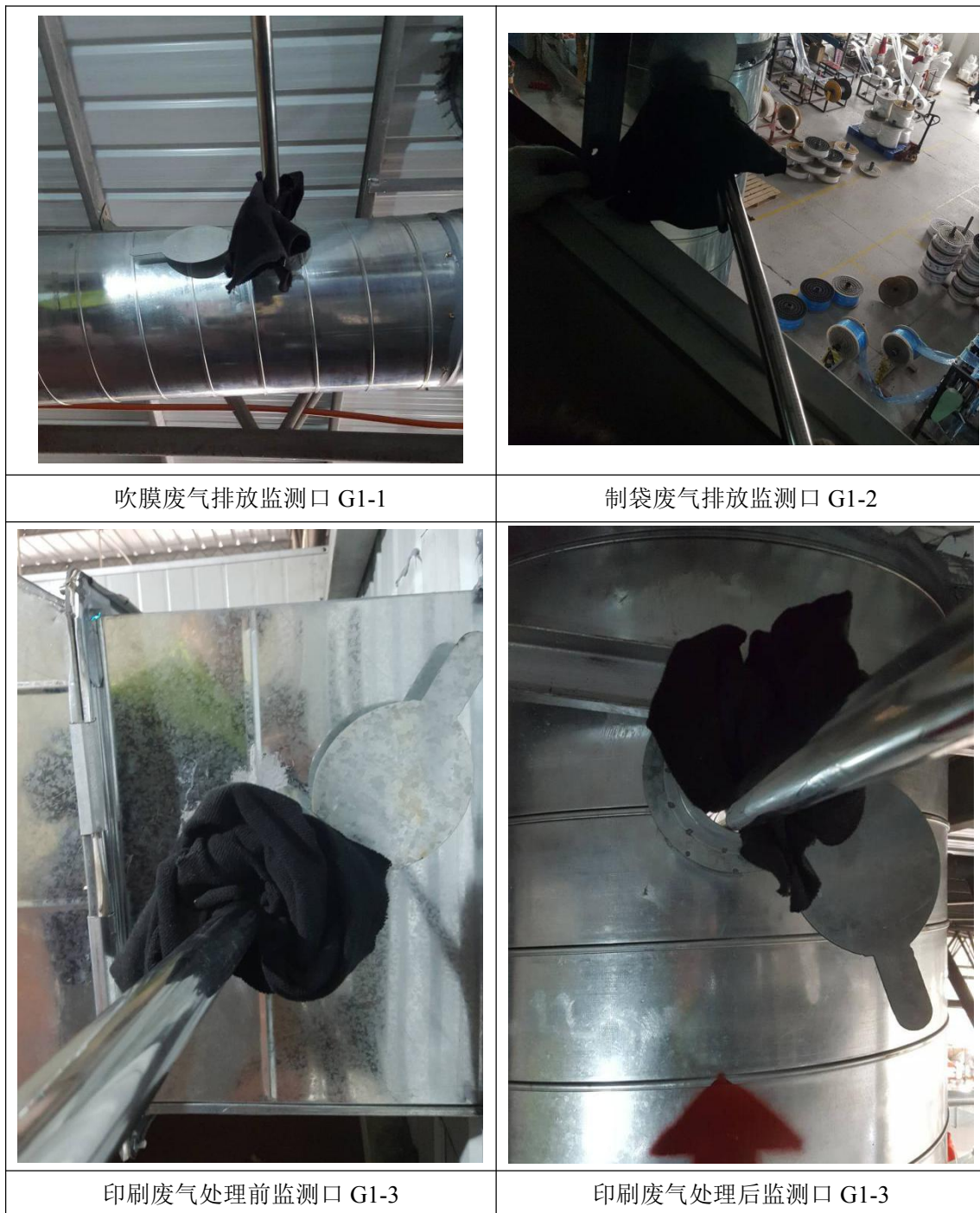
图 4.2.1-1 废气排放监测口图
