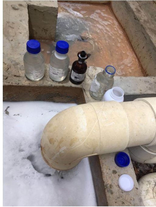
清洗废水处理后监测口
