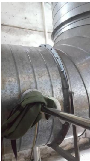
印刷废气处理前监测口
